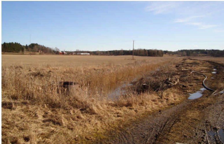
Figur 3. Markgärdetdiket med pumpstation.
