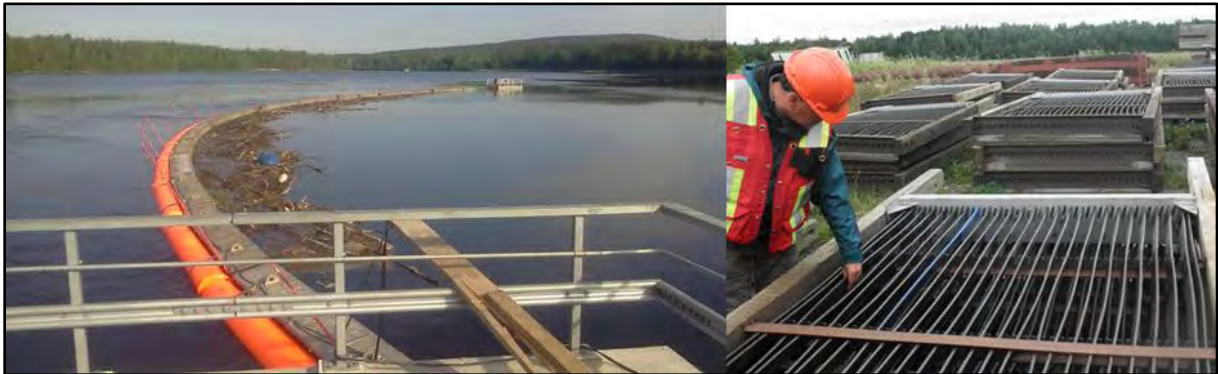
Figur 9. Ytavledare vid Norrforsdammen i Umeälven (vänster) och kanadensiska Louver-element (höger).
