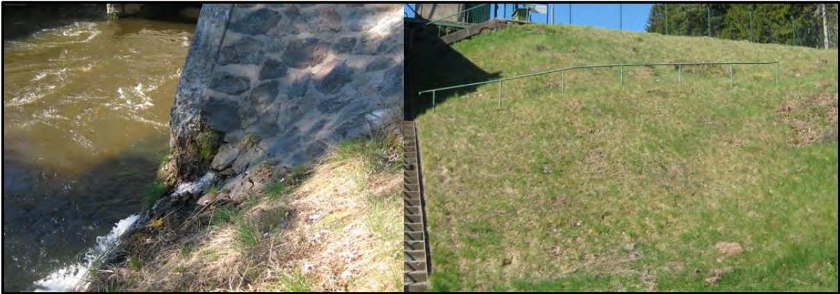
Figur 6. Läckagepunkt nedströms den vänstra sidan av turbinutloppet, samt nedströmsslänt vid vänster fyllningsdamm.
