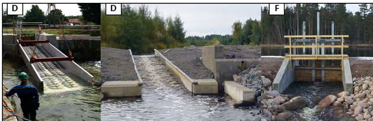
Figur 5. Exempel på tänkbara ingångar (bilderna till vänster) och utgång med flödesreglering (till höger) för inlöp.
