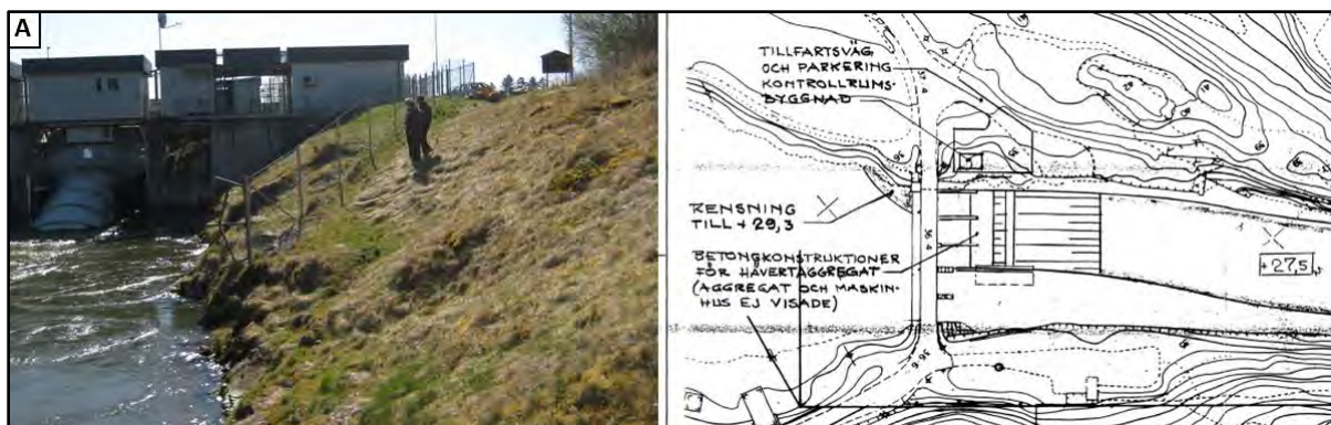
Figur 6. Brant slänt nedströms dammen vid föreslaget läget för ingång till fiskväg.
