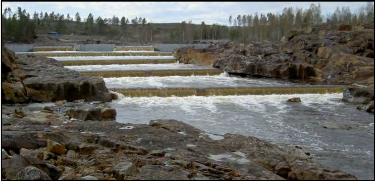
Figur 4. Gjutningar i Umeälven för att underlätta fiskpassage av vattenfall där flödena kan varieras från 10 m 3 /s till 1000 m 3 /s.
