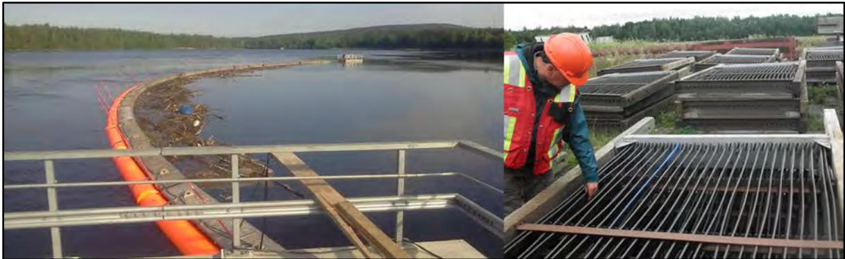
Figur 7. Ytavledare vid Norrforsdammen i Umeälven (vänster) och kanadensiska Louver-element (höger).
