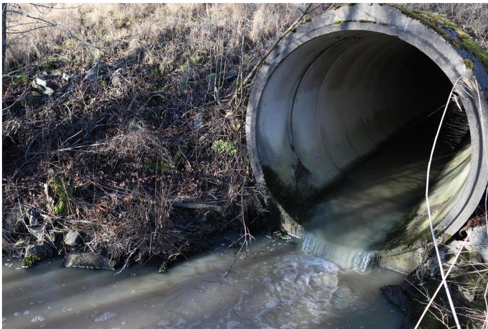
Figur 53. Ungefär 1 km uppströms bäckens mynningen finns en fellagd vägtrumma som skapar ett vandringshinder för fisk. Foto: Rickard Gustafsson.
