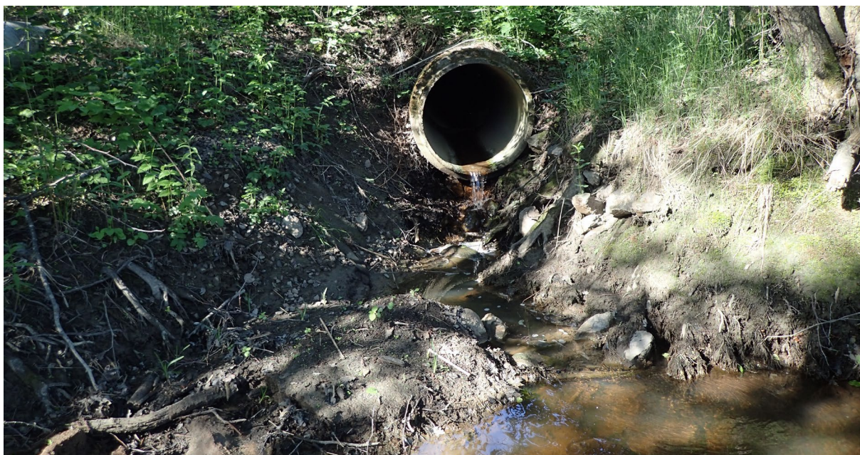
Bild 10. Dagvattenrör som mynnar i Pjältån uppströms passagen under Pjältvägen inom de centrala delarna av åtgärdsområde 2. Dagvattnet har bland annat orsakat erosionskador i anslutning till mynningen. Foto Jonas Edlund 2017-06-06.
